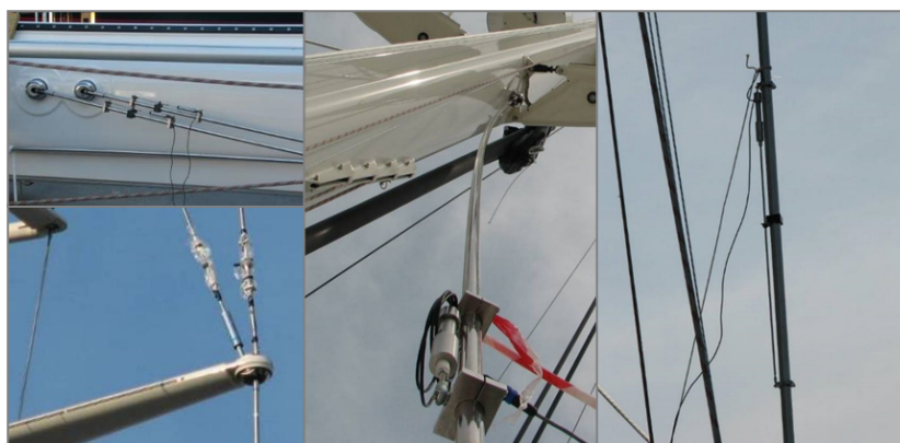
Figura 12: Sensori del sistema di monitoraggio installati a bordo.
